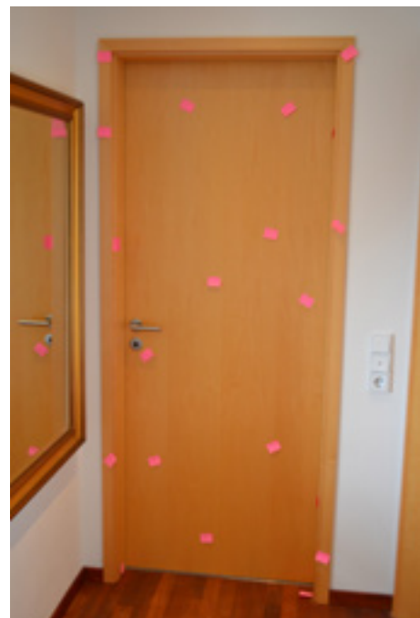
Eine solche Abnahmesituation ist nach den Regelwerken nicht zulässig. Die Markierungen sind vor der Prüfung zu entfernen.
